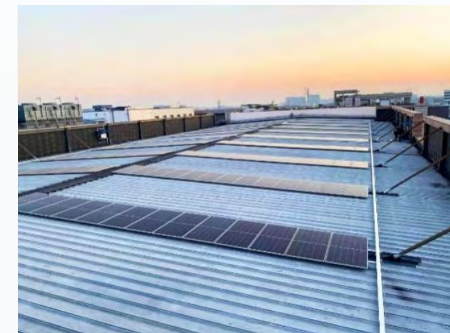
博兴数据中心光伏项目
